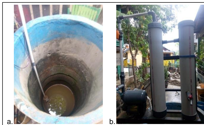
Gambar 5. Instalasi penjernih air: sumur penduduk yang dipasang pipa yang ujungnya dilengkapi dengan penyaring (a) dan alat penjernih air yang telah terpasang (b)
